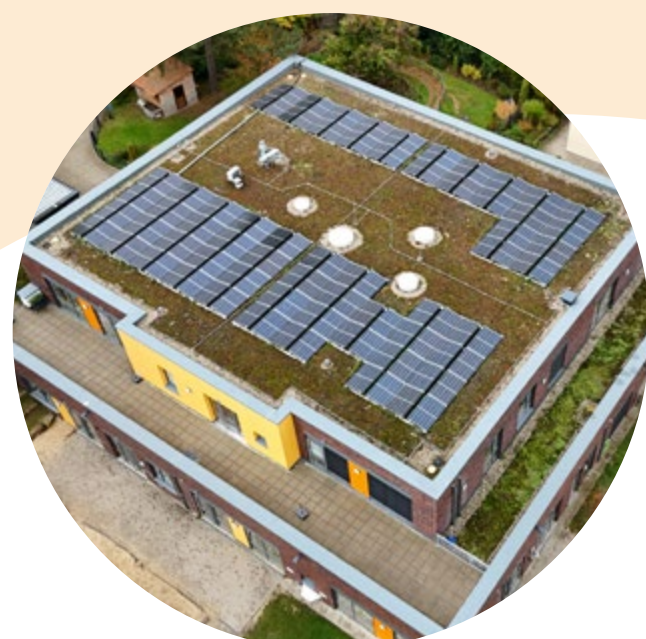
Kita Schatzkiste mit Gründach und PV Anlage
