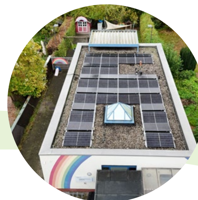
Kinderkrippe Regenbogen mit PV-Anlage
